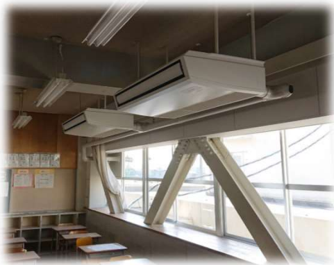
普通教室に設置した空調設備
