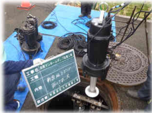
田熊マンホールポンプ設置状況
