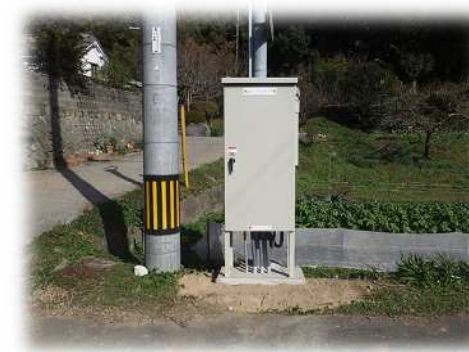
横山マンホールポンプ制御盤
