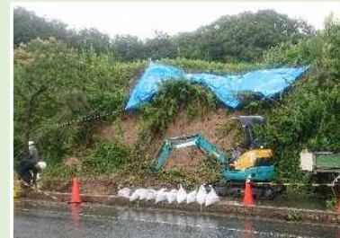
R3.8月豪雨による土木災害の現場(宗像・福岡線)
