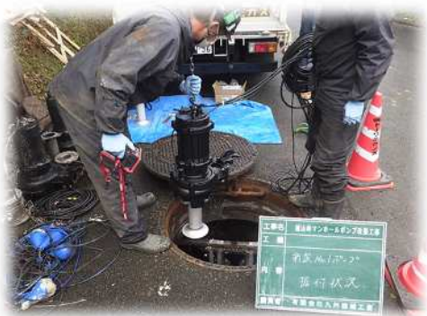
城山峠マンホールポンプ
