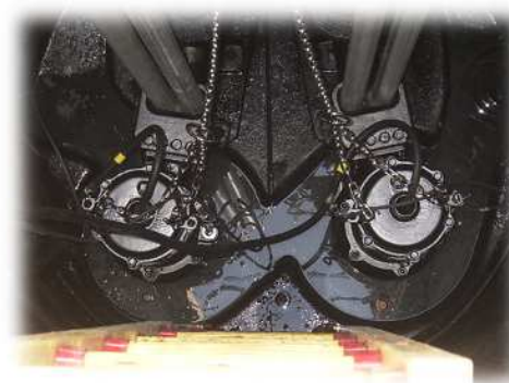
横山マンホールポンプ
