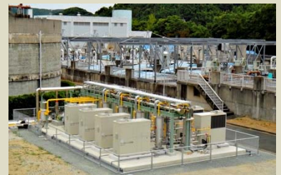
■消化ガス発電システム
