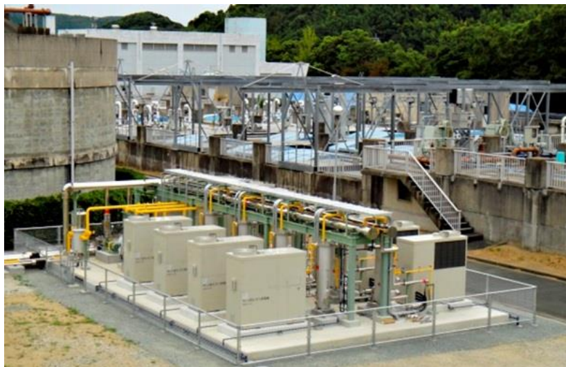
■消化ガス発電システム
