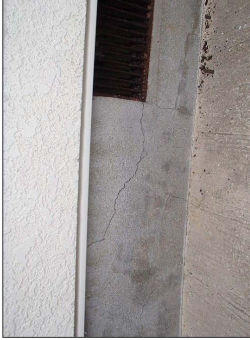
軽微なひび割れ有り
