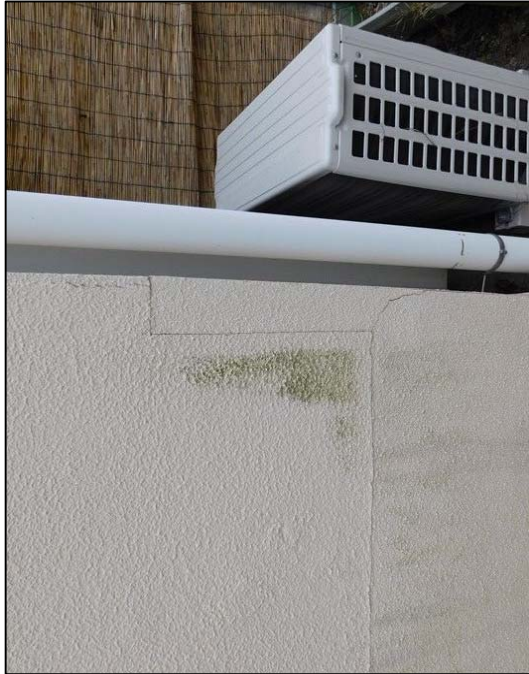
軽微なひび割れ有り
