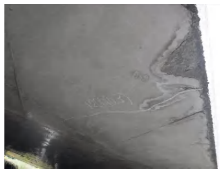
ひびわれ・漏水・遊離石灰(主桁:健全性Ⅰ)
