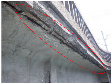
鉄筋露出(地覆:健全性Ⅱ)
