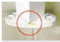
PCB油が漏れた事例
