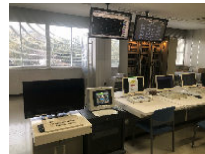
宗像終末処理場中央監視設備
